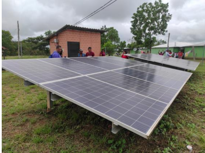
Figura 2. - Generador fotovoltaico para 10 usuarios (Comunidad las Villas)
